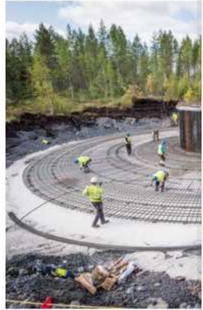
Perustukset. Tuulivoiman valtavan nopea lisääminen on tuonut teollisille investoinneille. Kuvassa tuulivoimalan perustusten rakentamista.
